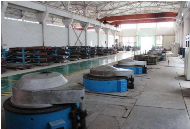
热车间井式炉（多面热源）
