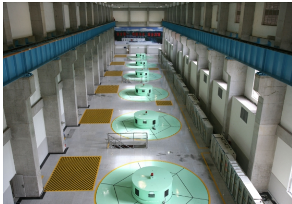
水电站发电机层(多体热源)
